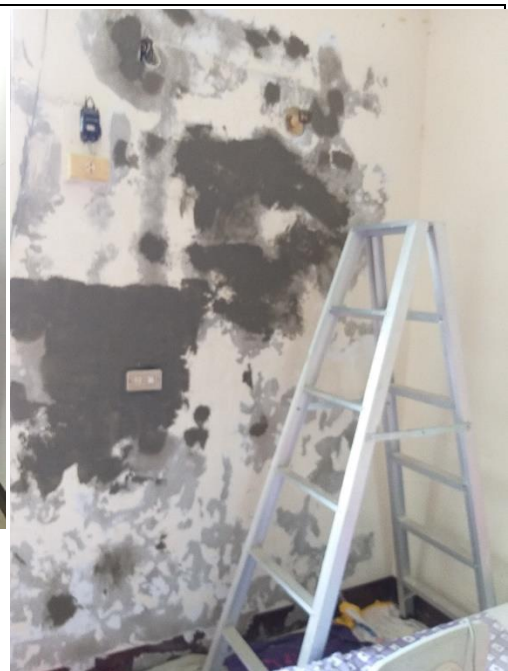
老房子各房室壁癌已影響呼吸道 不適，自己處理
